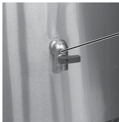
1. Kontrollventil för vattennivån
